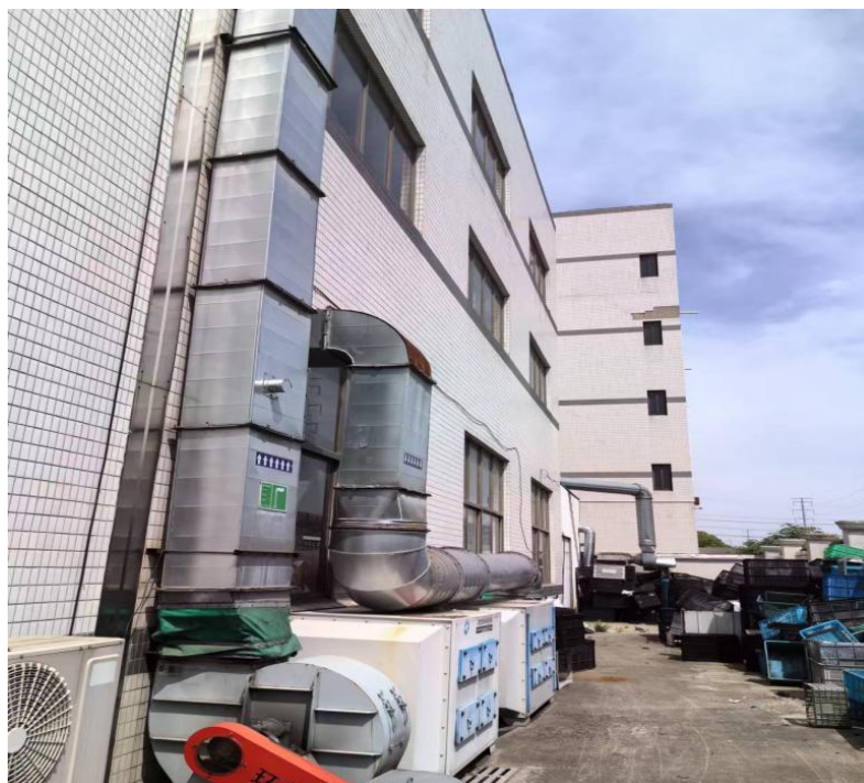
注塑废气（含危废仓库贮存废气）处理设施 （两级活性炭吸附装置+15米高1#排气筒）
