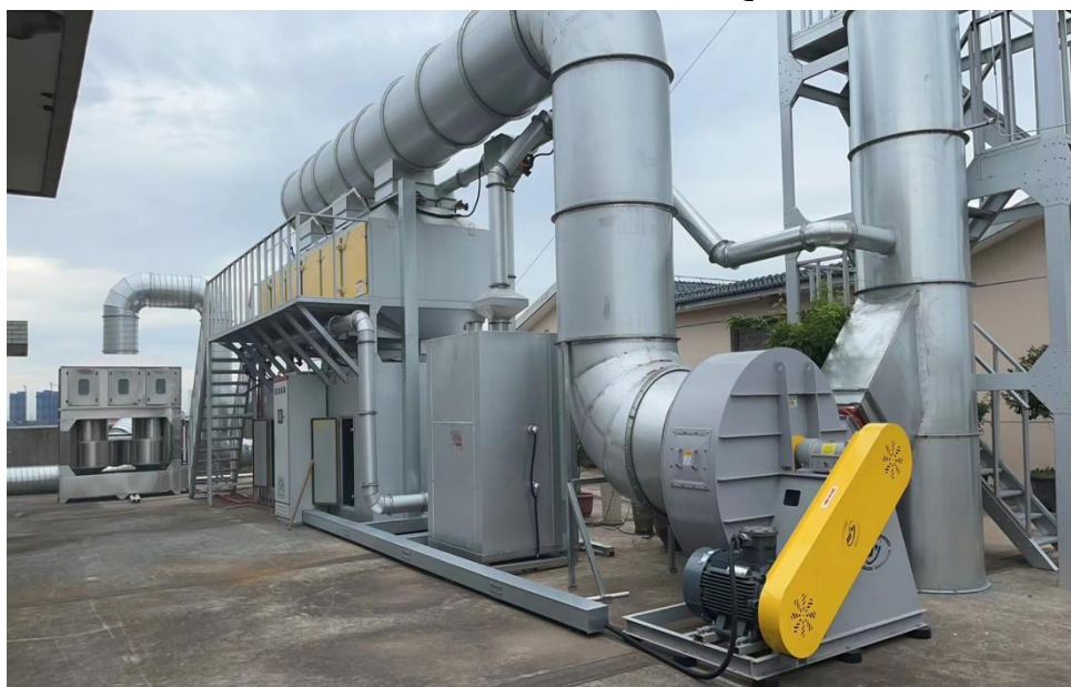
喷漆线废气治理设施 (水旋+干式过滤棉+两级活性炭吸附+CO 催化燃烧 +30 米高 FQ-4 排气筒)
