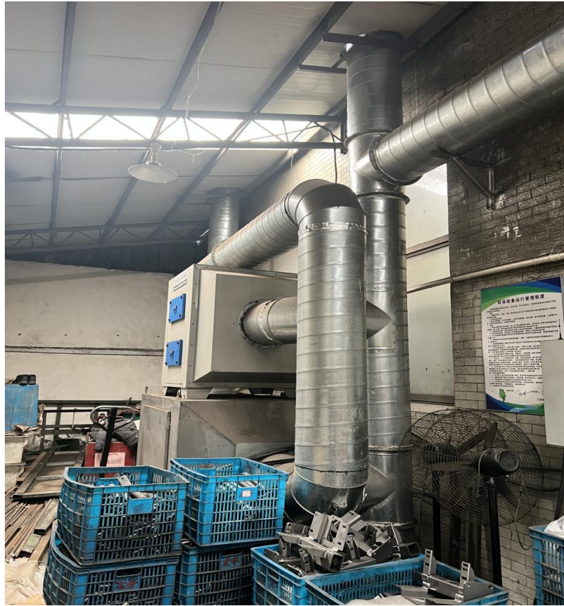
注塑废气处理设施（两级活性炭吸附装置+30 米高 FQ-2 排气筒）
