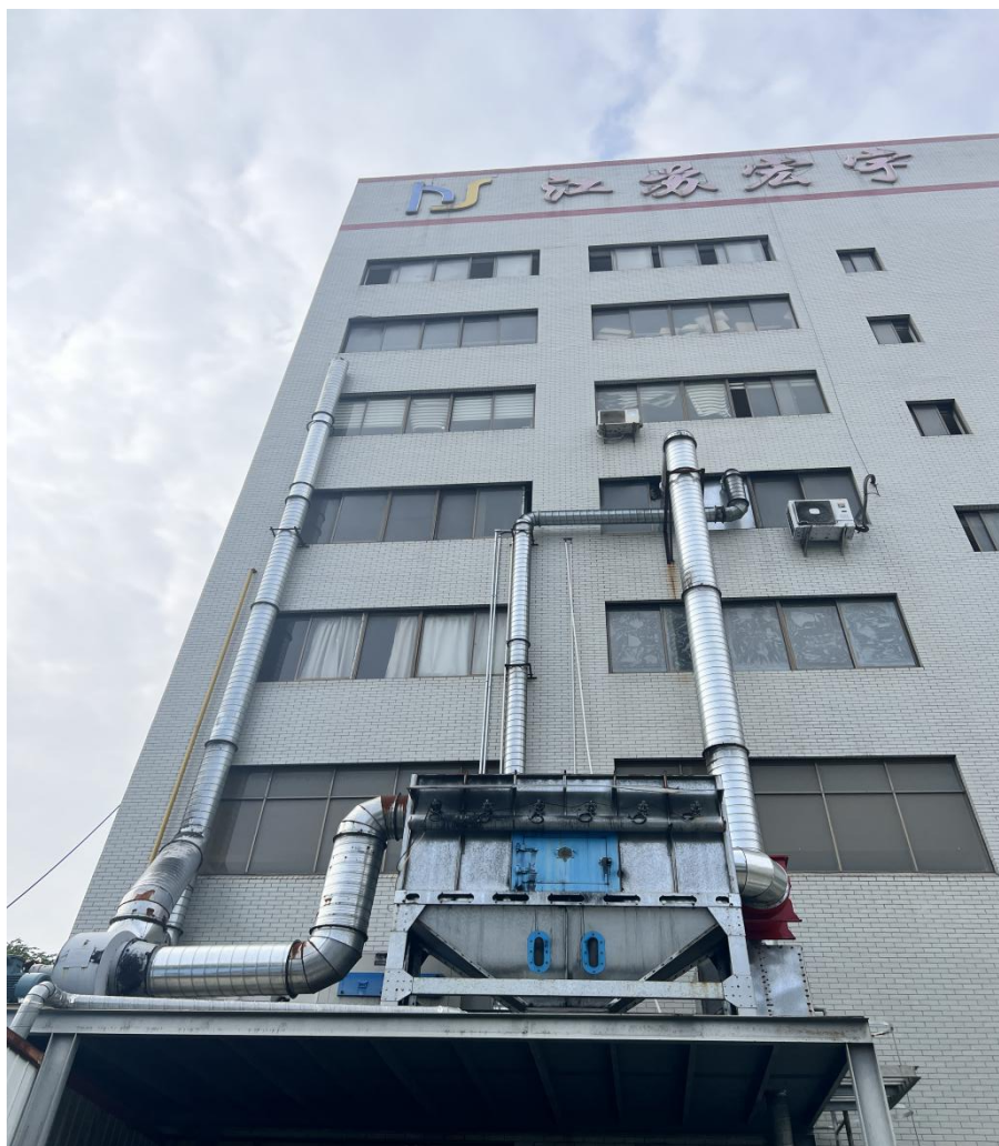
喷塑粉尘/危废仓库废气处理设施 (脉冲除尘/两级活性炭+30 米高 FQ-3 排气筒)
