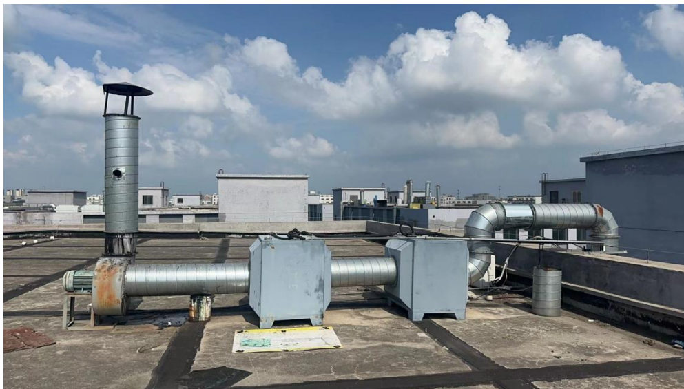
图 3-1 吹塑废气处理设施（二级活性炭吸附装置）
