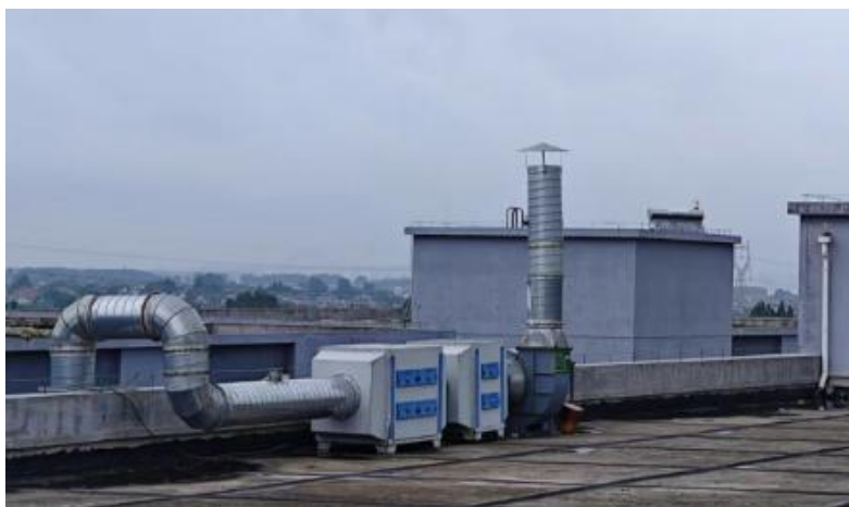
注塑废气处理设施（两级活性炭吸附装置+25米高排气筒（FQ-1））
