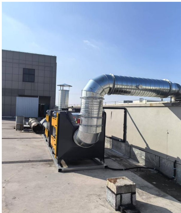
废气处理设施（过滤棉+两级活性炭吸附装置+15 米高排气筒（FQ-01）
