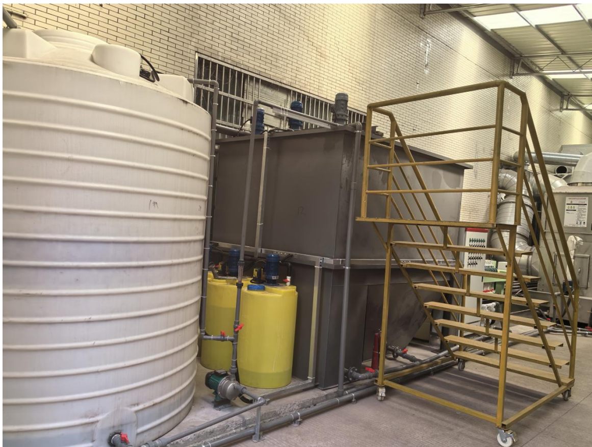
图 4.2-3 废液处理装置现场照片
