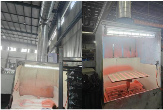
车间一溶剂型胶粘剂喷胶台废气收集集气罩
