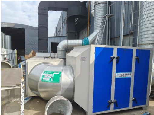
车间一 16#排气筒废气处理设施
