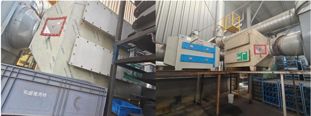
车间一 1#排气筒废气处理设施 车间二 2#排气筒废气处理设施
